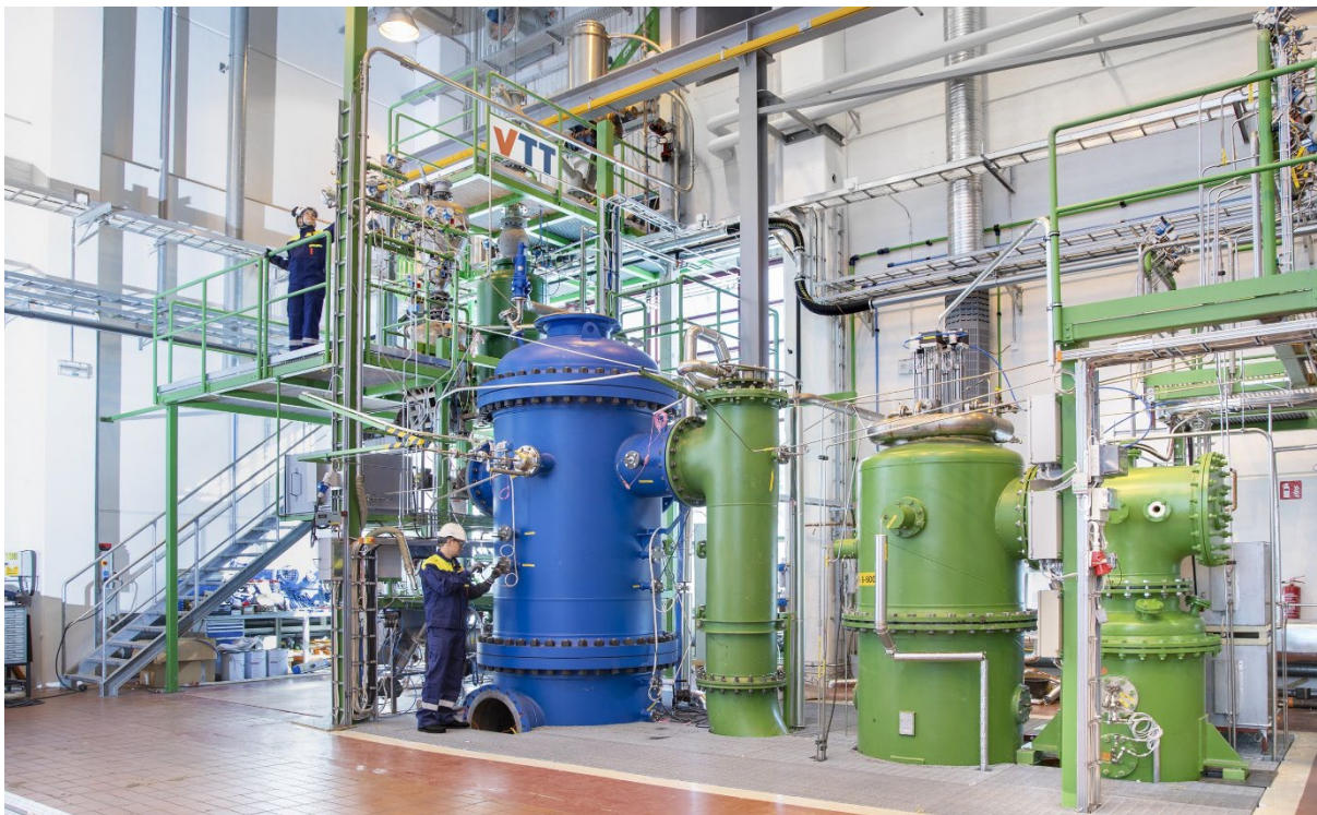
Figur 14: VTTs trycksatta förgasningsanläggning i Esbo, Finland
